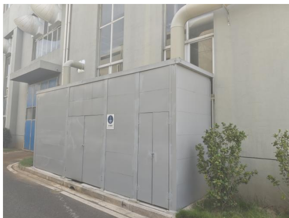
静电喷淋除尘
